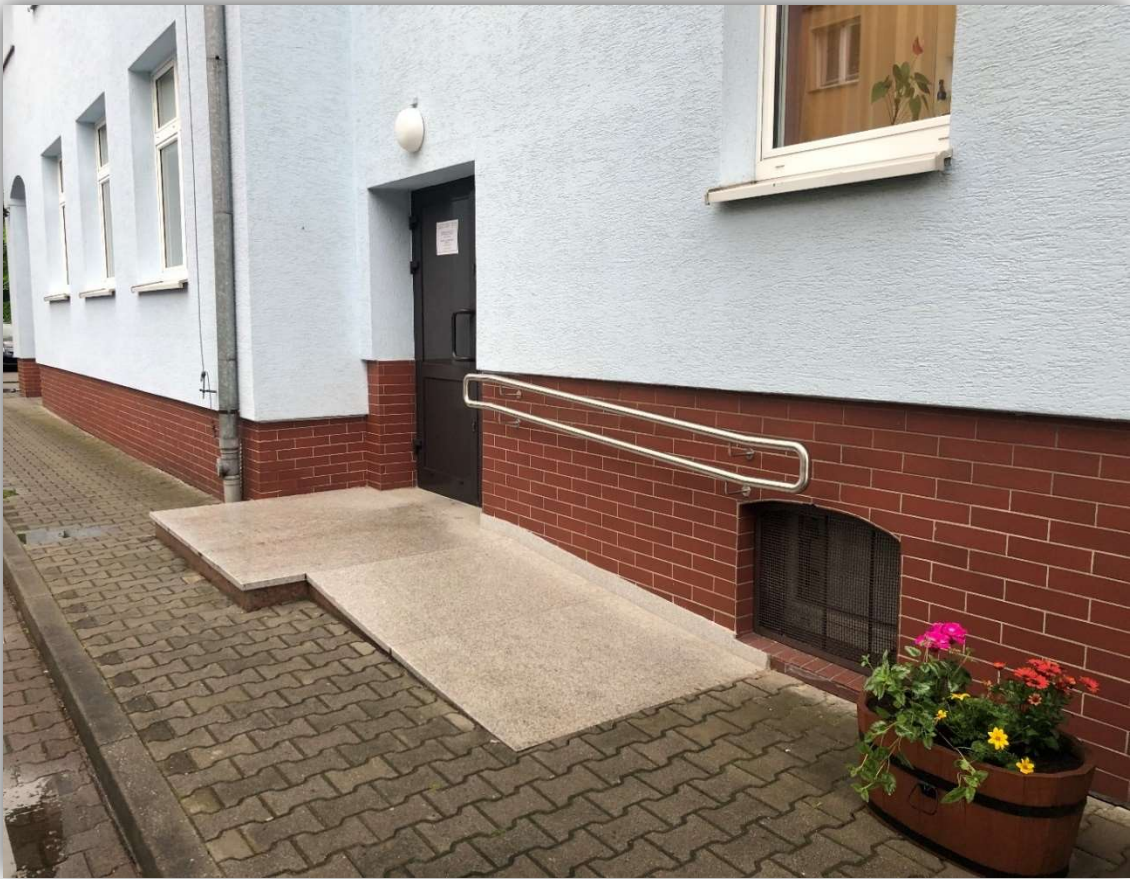
Foto: Wykonanie podestu oraz podjazdu dla niepełnosprawnych przy wejściu głównym do budynku Urzędu Miejskiego w Tułowicach.
