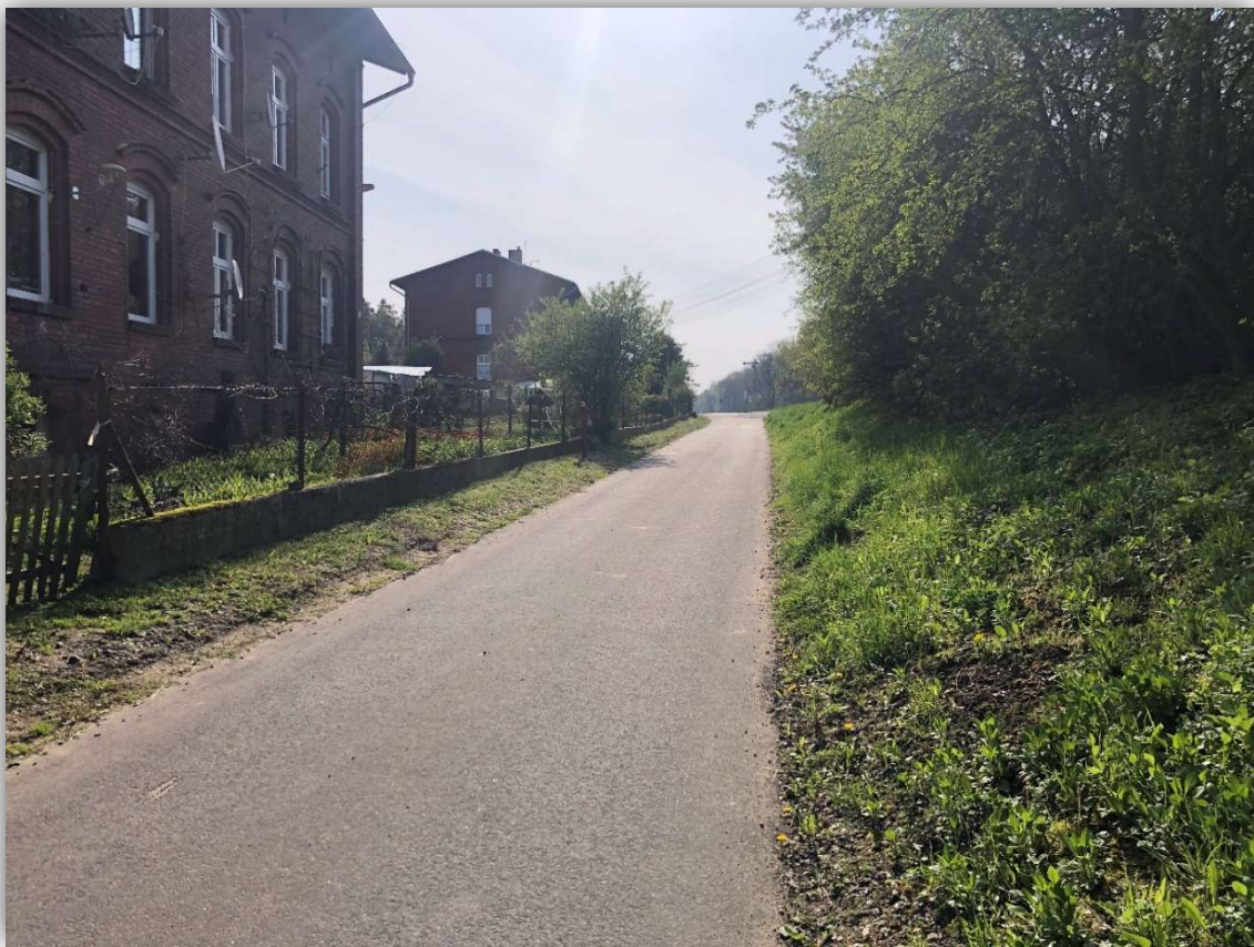
Foto: Budowa sieci kanalizacyjnej w Szydłowie na ulicy Kolejowej wraz z obudową nawierzchni drogowej.
