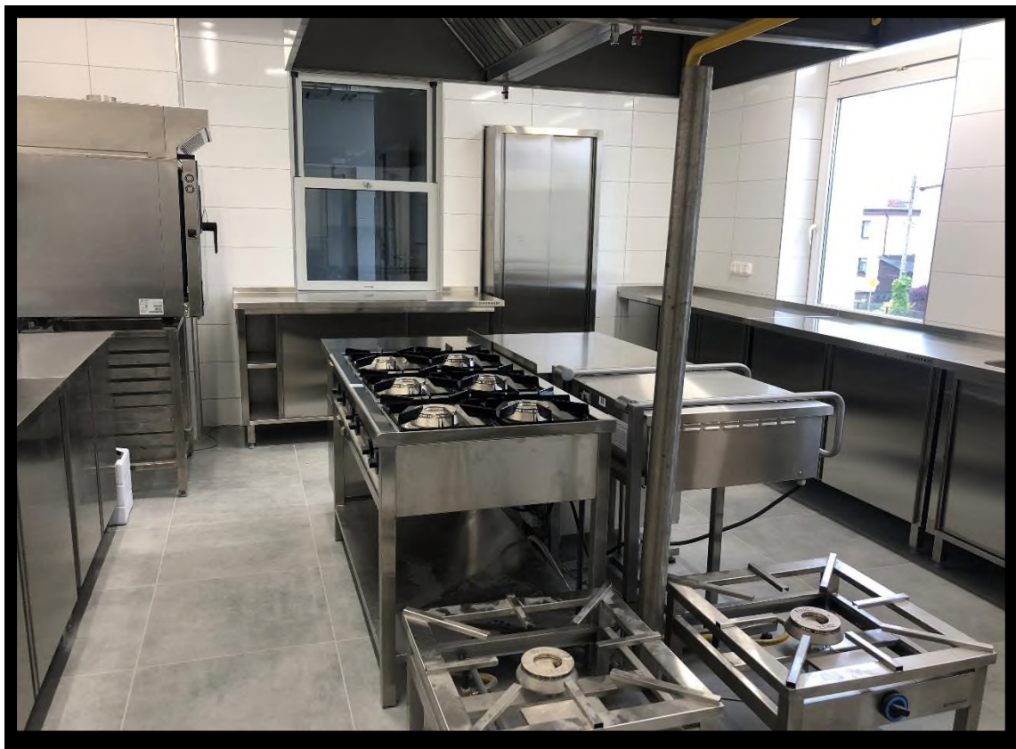
Foto: Przebudowa budynku przedszkola w Tułowicach – pomieszczenie kuchni wraz z wyposażeniem
