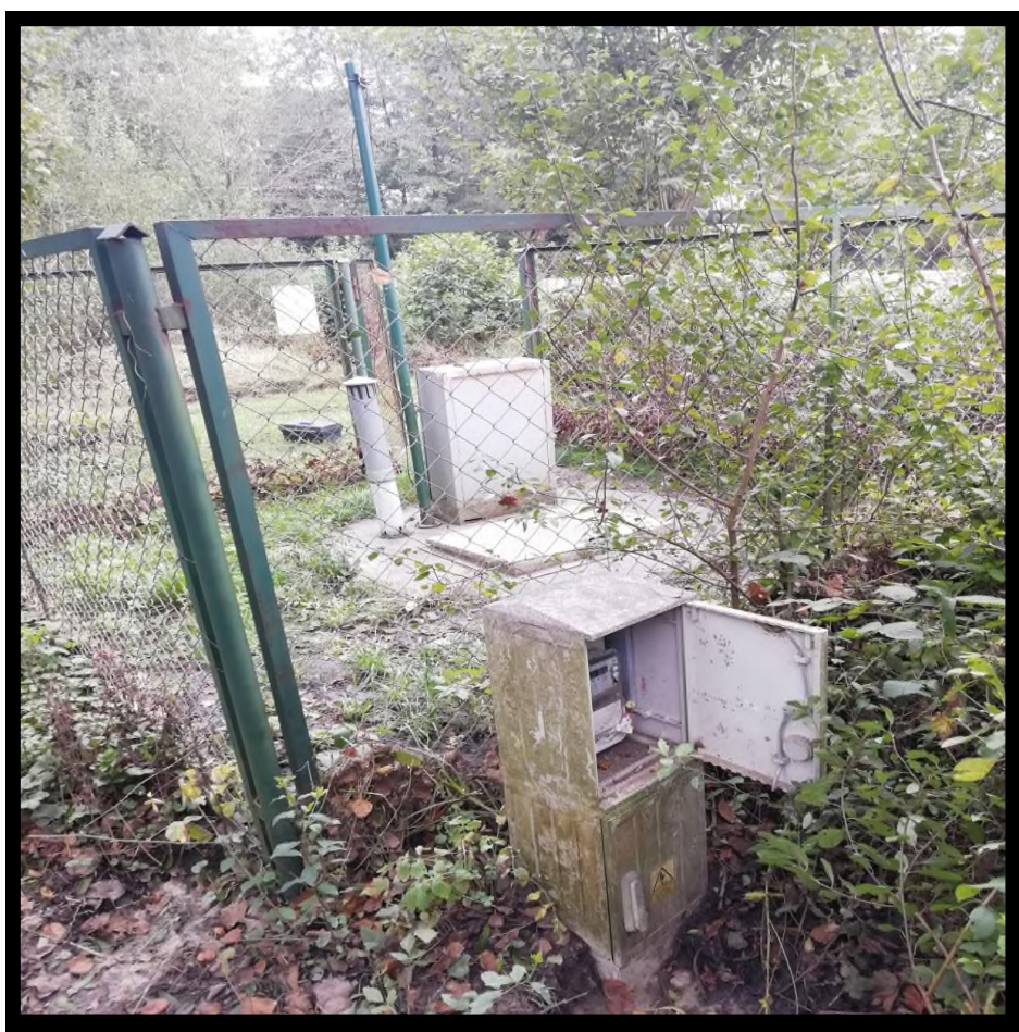
Foto: Wrzesień 2024 r. przepompownia ścieków w Sołectwie Ligota Tułowicka, uszkodzona skrzynia zasilająca przez wody powodziowe.
